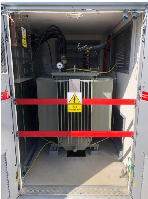
Rysunek 16 Stacja transformatorowa z misą do wycieku oleju (źródło: fotografia własna).
