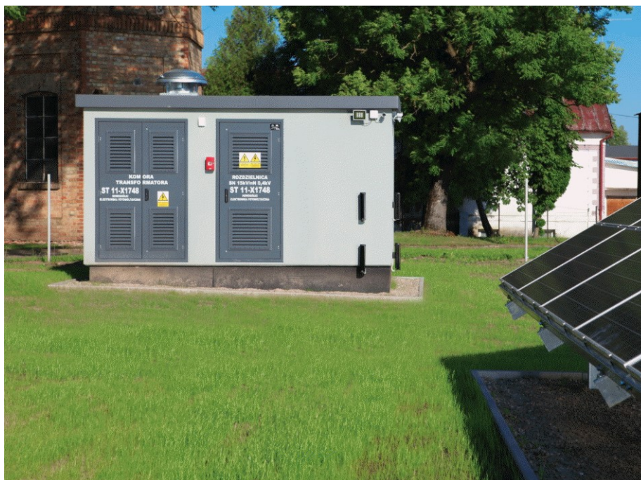
Fot. 17. Przykładowa kontenerowa stacja transformatorowa ( https://gosolar.pl/ )
