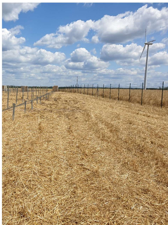
Fot. 12. Przykładowe ogrodzenie farmy fotowoltaicznej
