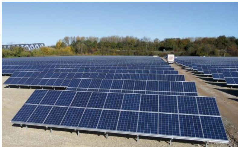
Fotografia 7 Elektrownia fotowoltaiczna w Iffezheim (źródło: http://www.wuerth-solar.de/solar/de/wuerth_solar_2012/unternehmen_1/referenzen_4/referenzen_12/referenzen.php 05.11.2012)
